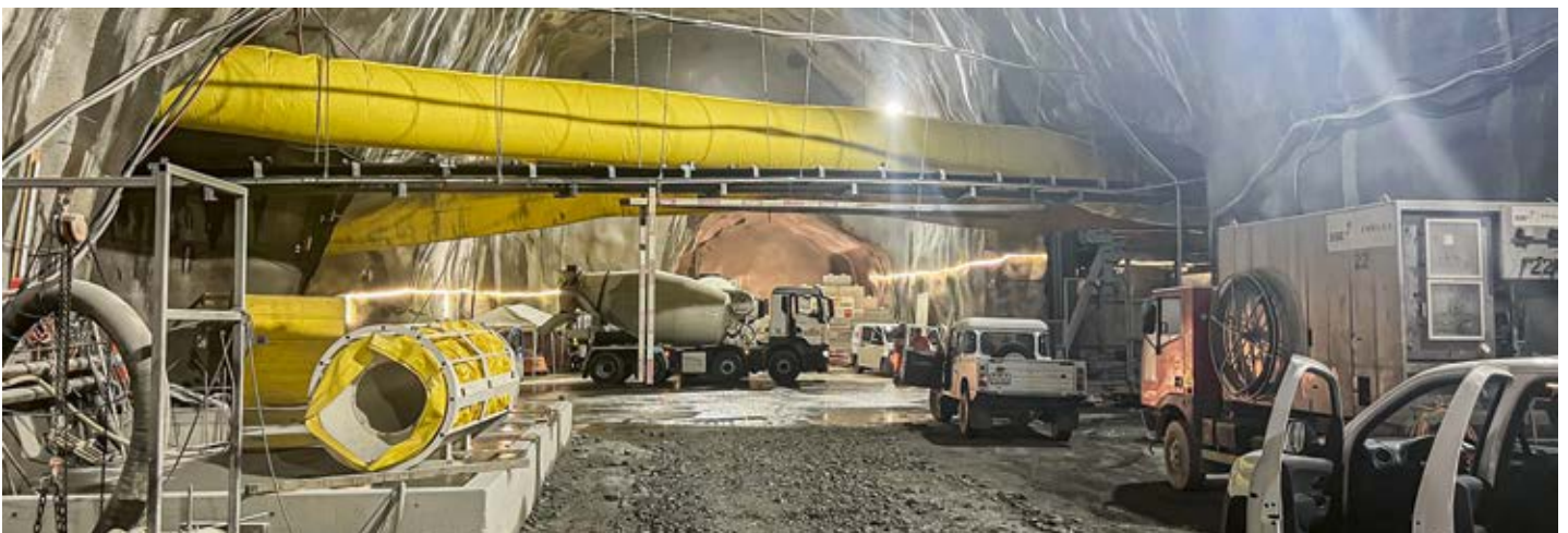
ARBEITEN VORLOS AUSBRUCH DER BETONKAVERNE (OBEN UND UNTEN) SOWIE SPRITZBETONARBEITEN BEIM TRANSPORTSTOLLEN (MITTE).
